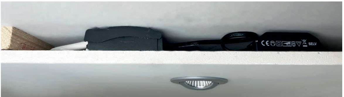
6 - Das Ergebnis: eine kompakte Installation mit einem schwenkbaren Spot, einem dimmbaren Netzgerät sowie der Möglichkeit zur Durchgangsverdrahtung im Deckenhohlraum – ideal im Sanierungsbereich.
